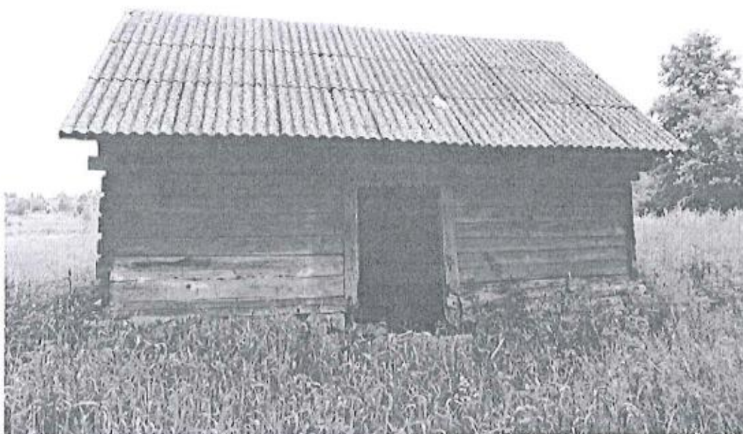
Rys. 9. Budynek pokryty azbestem falistym (Źródło: Fotografia własna)
